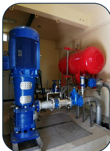
Station des captages de Dracy
